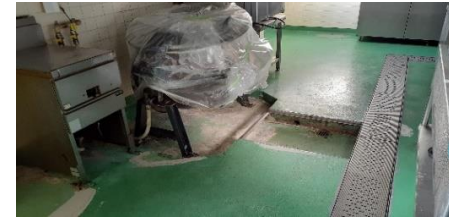
回転釜付近の床の剥がれを補修し塗料を塗ります。(工期8月10日～12日)
